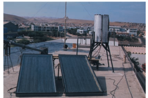
Fig. 8 Sistema paneles solares estanque, inclinación 19° orientado hacia el Norte.
