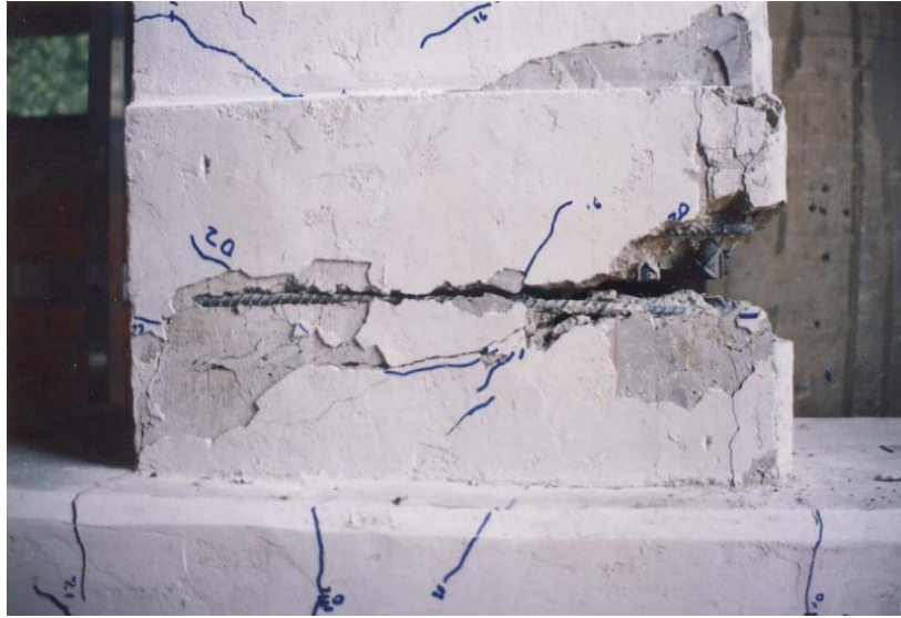
Figura 8. Falla típica observada en especímenes
