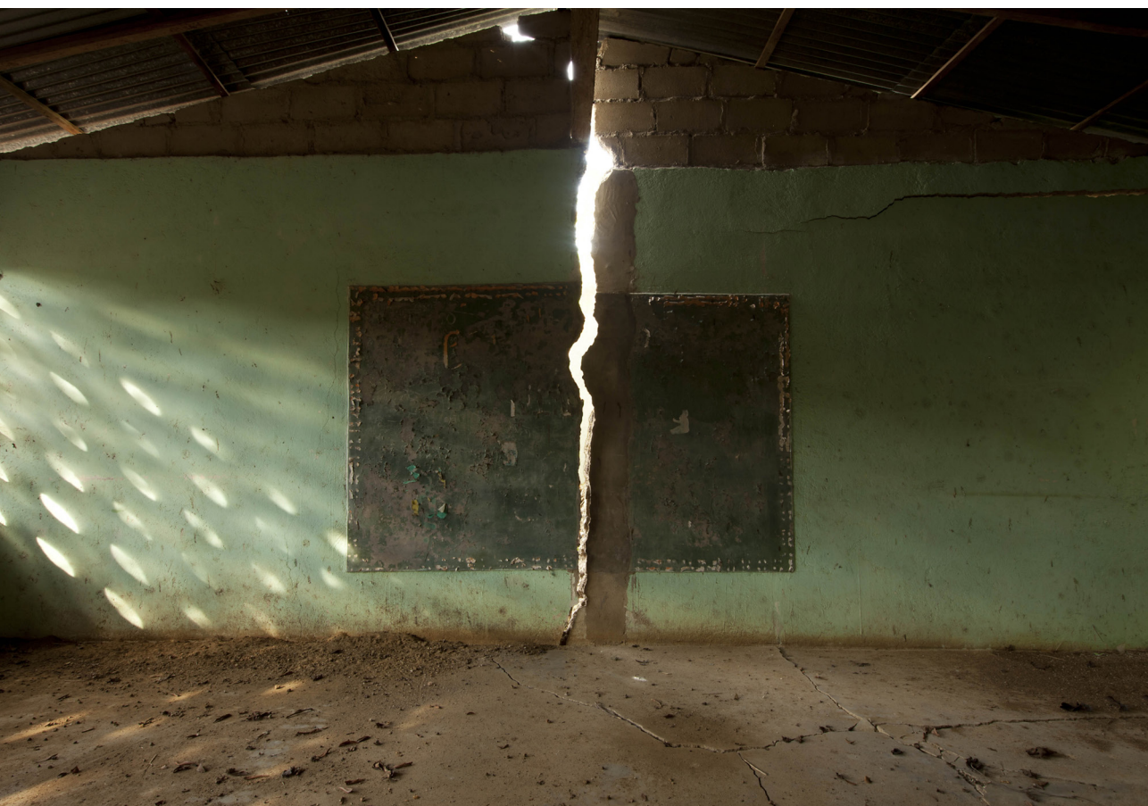
Figura 3. Silencio con grieta. Las Palmas, Bolívar, Colombia, 2011
