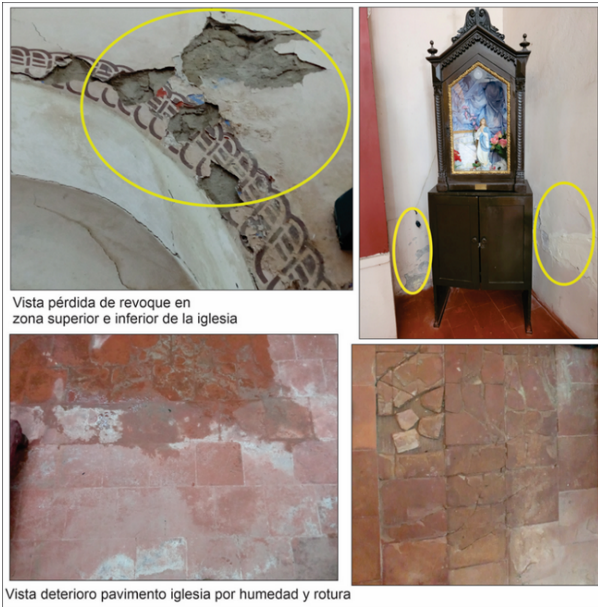
Figura 11. Vista patologías presente en iglesia Fundacional Fuente: Elaboración propia.
