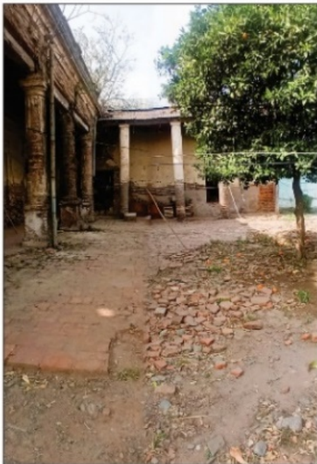
Desprendimientos pavimento patio
