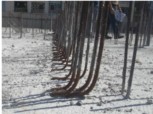
Figura 1. Desplazamiento del acero de refuerzo de la cimentación para el anclaje de los muros
