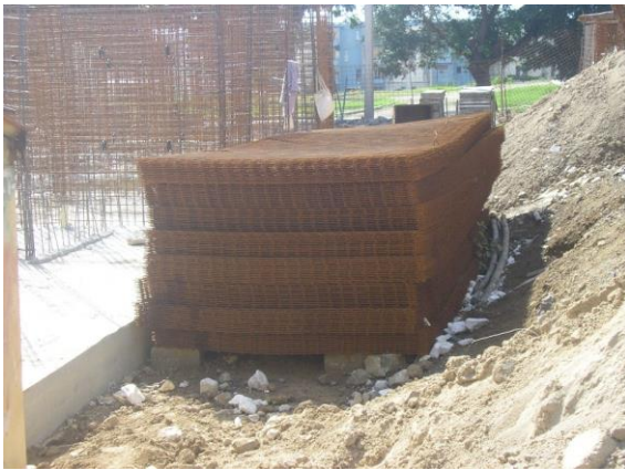
a) almacenamiento inadecuado
