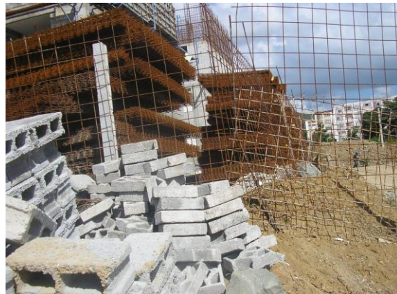
b) mallas con algún grado de oxidación
