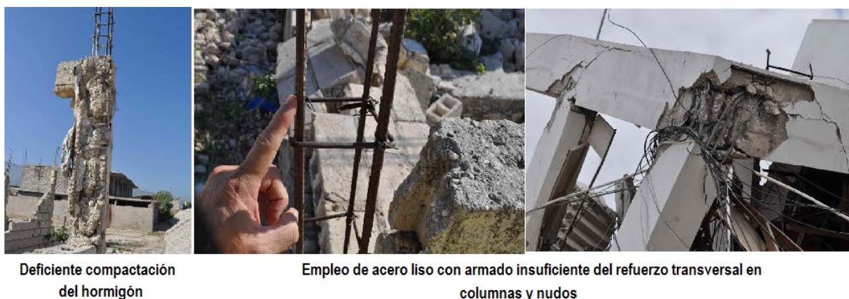
Fig. 3. Daños en estructuras de hormigón armado durante el sismo de Haití en enero 2010. Fuente: Fierro, 2010.
