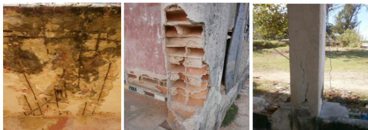
Figura 1. Lesiones en las edificaciones en la zona costera de Santa Fe: humedad, erosión, fisuras
