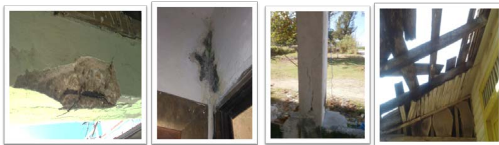
Figura 2. Evidencias de principales patologías encontradas en los inmuebles con tipologías constructivas I (Hormigón) II (Mampostería), III (Mampostería y Cubierta ligera) y VI (Madera) 2018-2019
