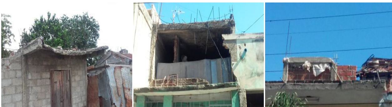
Figura 2. Viviendas inadecuadamente construidas en Santiago de Cuba
