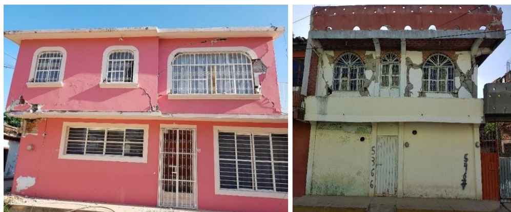
Figura 1. Daños en viviendas de mampostería deficientemente confinadas
