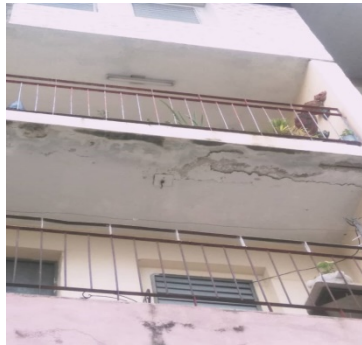
b) Manchas de humedad en balcones
