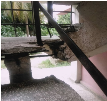
a) Deterioros en escaleras
