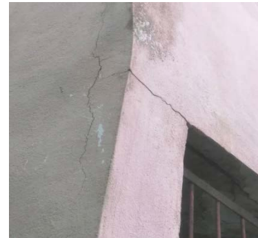
c) Grietas en elementos estructurales
