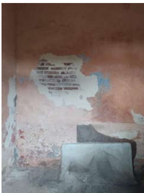
Fig. 6. Interior de los restos de una construcción en estado de derrumbe ubicada al borde de las vías de ferrocarril de la Estación Quiñihual (2020).
