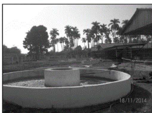
Foto 2. Biodigestor de 50 m 3 .
