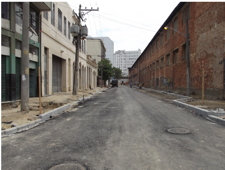
Figura 24 – Findas as intervenções, a Rua Coelho e Castro novamente asfaltada. À direita, o grandioso Armazém nº 5. Foto: Andrea Jundi.
