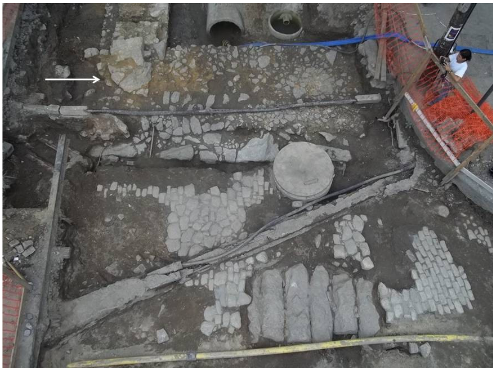
Figura 38 – Adjacentes aos antigos calçamentos do Beco da Pedra do Sal, podem ser vistos os alicerces da fachada lateral e dianteira do lote nº 68, bem como o cunhal curvilíneo (assinalado com uma seta) que atesta sua localização em uma esquina, antes da ampliação. Foto: Andrea Jundi.
