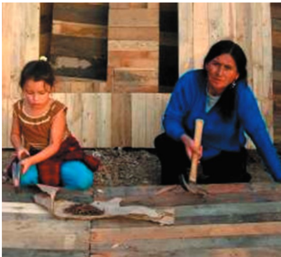
Pobladora de la ciudadela de Pachacutec, que construye junto con su familia casas prefabricadas para la venta.
