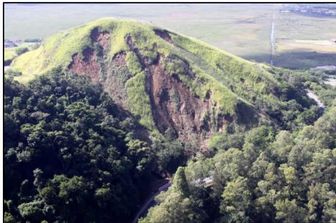
Figura 9 - Registro fotográfico do escorregamento na Estrada da Grota Funda em abril de 2010
