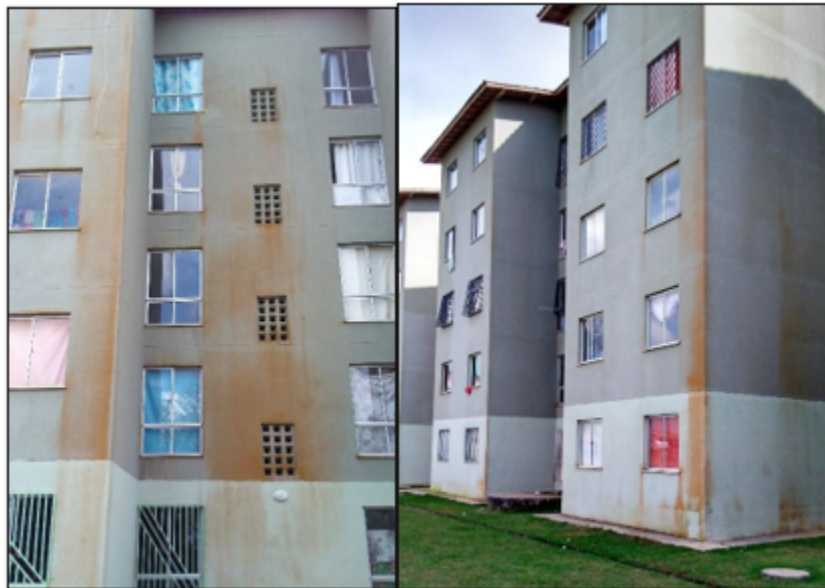
Imagem 1 – Prédios do Condomínio São Francisco com Marcas de Poeira
