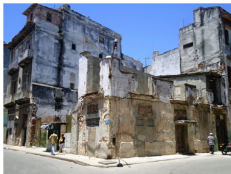
Figura 3. Edificaciones con avanzados deterioros en el Consejo Popular Colón. Fuente: Foto autores.
