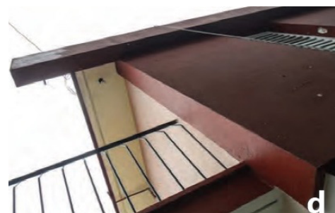
Figura 10. Estructura vertical: a) muro de ladrillos, b) muro de bloques, c) muros calados y con salientes, d) con excentricidad estructural. Fuente: A.J. Rouco, 2020.
