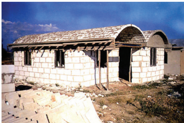
Figura 6. Vivienda en construcción en Matanzas con paredes de canto y cubierta de bóvedas del mismo material local. Es posible apreciar los tensores y aleros contrafuertes de hormigón armado para contrarrestar el empuje horizontal de las bóvedas. Fuente: Ruiz y otros, 1998.
