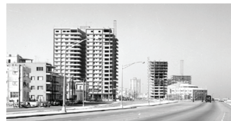
Figura 2. Construcción de nuevas torres en el litoral de El Vedado durante los años 50. Fuente: Archivo fotográfico del MOP.
