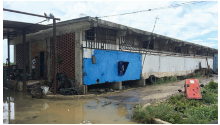
Figura 14. Estado constructivo del almacén de insumos, utilizado actualmente como vivienda. Fuente: Autores, agosto de 2023.
