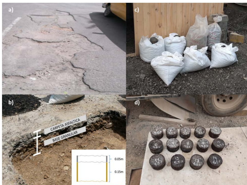
Figura 4. a) Vía deteriorada; b) calicata en la zona de estudio; c) toma de muestras para ensayos; d) diseño de mezcla-elaboración de briquetas
