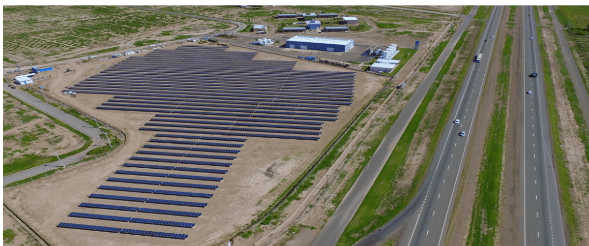
Parque solar PASIP Ecocuyo
