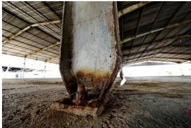
Figura 3 – degradação do aço por oxidação.
