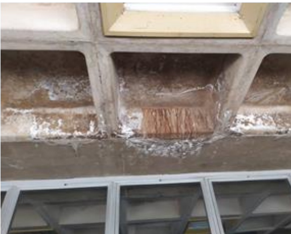
Figura 7. Manchas blancas y sangrado en losa reticular. Fuente: los autores
