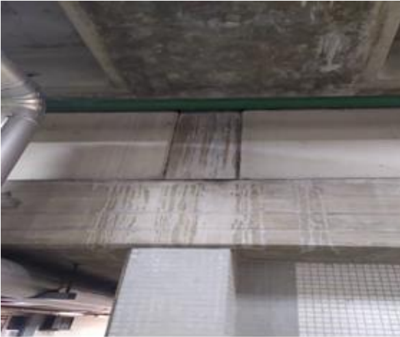
Figura 6. Manchas en vigas. Fuente: los autores
