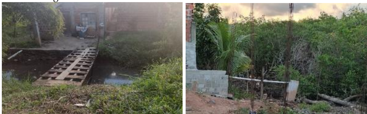
Painel 1– Esgotamento sanitário no bairro Teotônio Vilela
