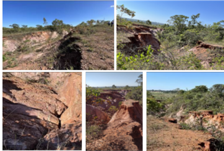
Figura 2 – Processos erosivos no PNB – área utilizada como “caixa de empréstimo durante” a construção de Brasília
