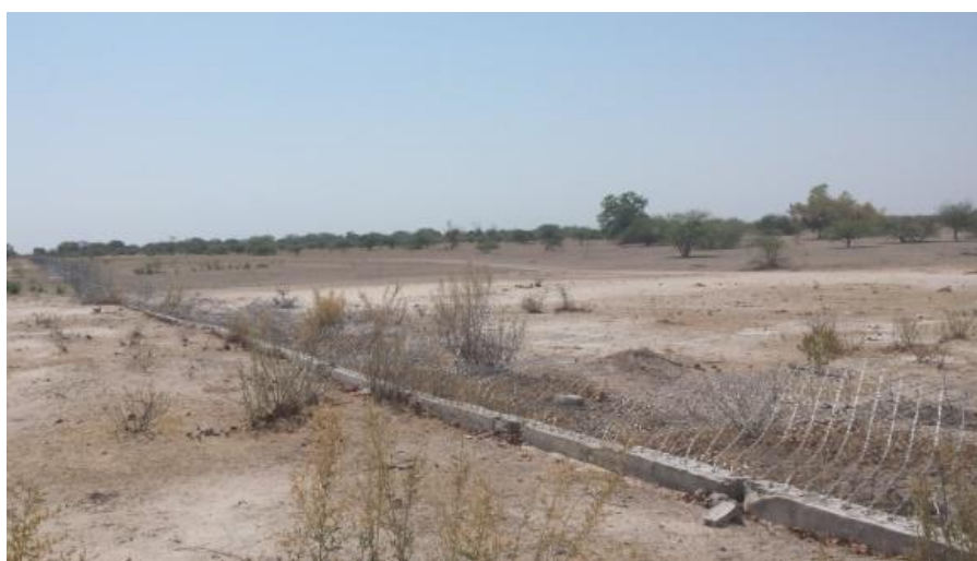
Figura 06: Rede destruída (Angola)
