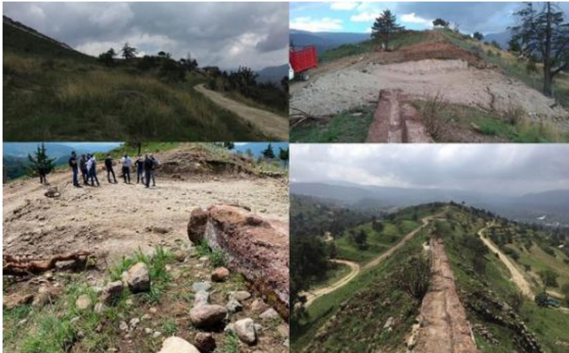
Figura 15 Fotografías de la destrucción del acueducto ‘caño quebrado’.
