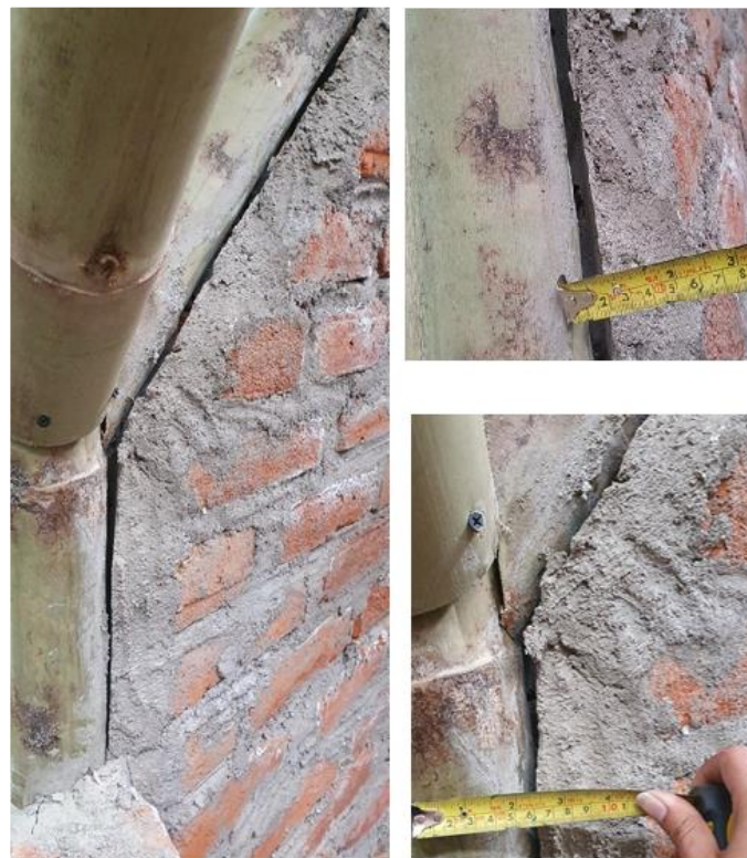
Figura 7. Separación entre la mampostería y la estructura espacial hexagonal de caña G. angustifolia obtenida durante el ensayo a carga lateral.
