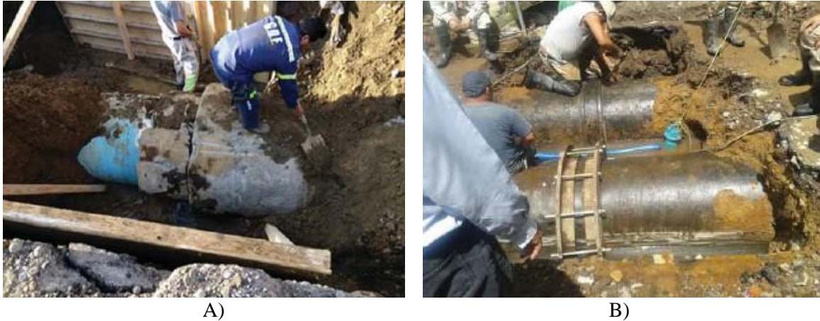
Figura 8. Fugas en red primaria de la Ciudad de México derivadas del sismo del 19S de 2017: A) Tubería de asbesto-cemento de 48 in ubicada en Tláhuac y B) Tubería de acero de 30 in situada en Xochimilco.
