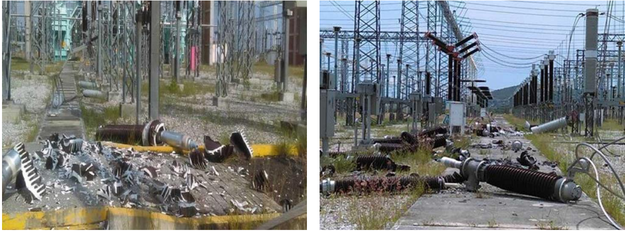
Figura 7. Daños en la subestación Yautepec, Morelos ocasionados por el sismo del 19S de 2017. Fuente: Excélsior
