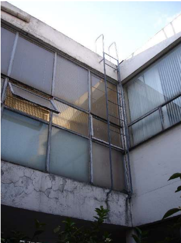
Figura 4. Vista del deterioro de la casa antes de su transformación en 2010
