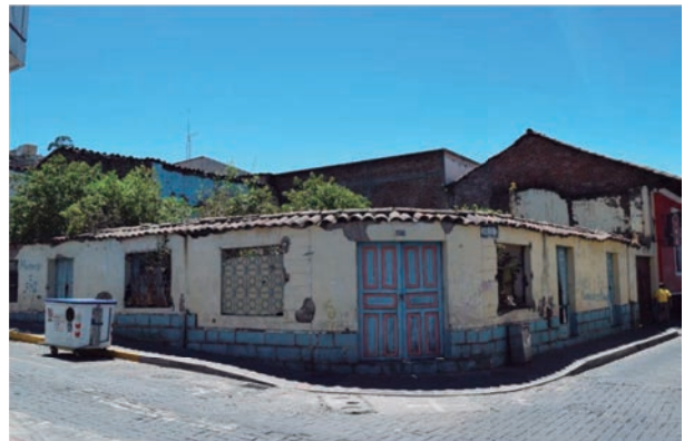
Casa patrimonial destruida
