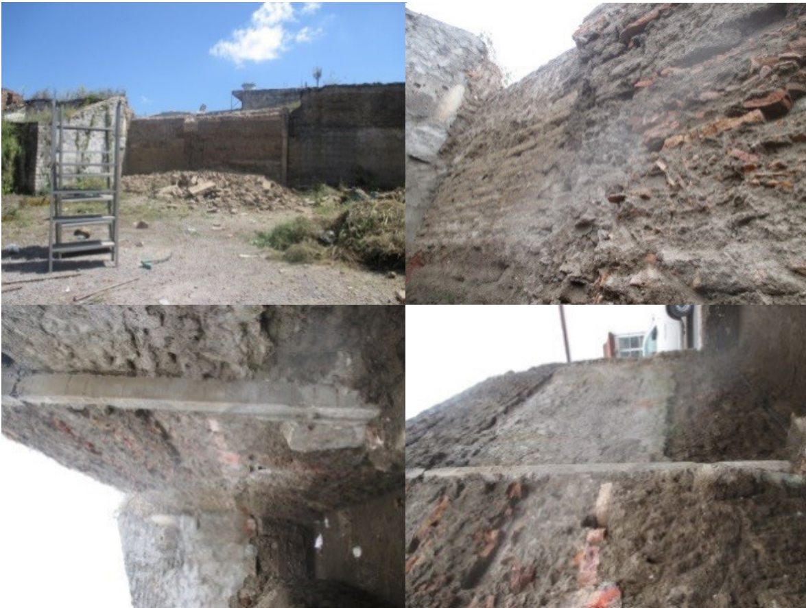
Figuras 32, 33, 34 y 35 Vista del muro de adobe, el cual tiene una altura de 4.72 m; corresponde al muro Oeste de la casa Este, el cual se encontró modificado al colocar castillos de concreto para reforzarlo. Sus cimientos cuentan con un relleno de fragmentos de tabique y ladrillo con 0.92 m de altura, visibles en el eje de excavación de la letra I, en los ejes del 2 al 8.
