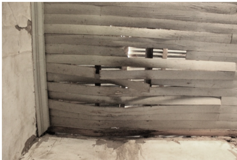
Figura 7. Patología en cielorraso. Fuente: elaboración propia
