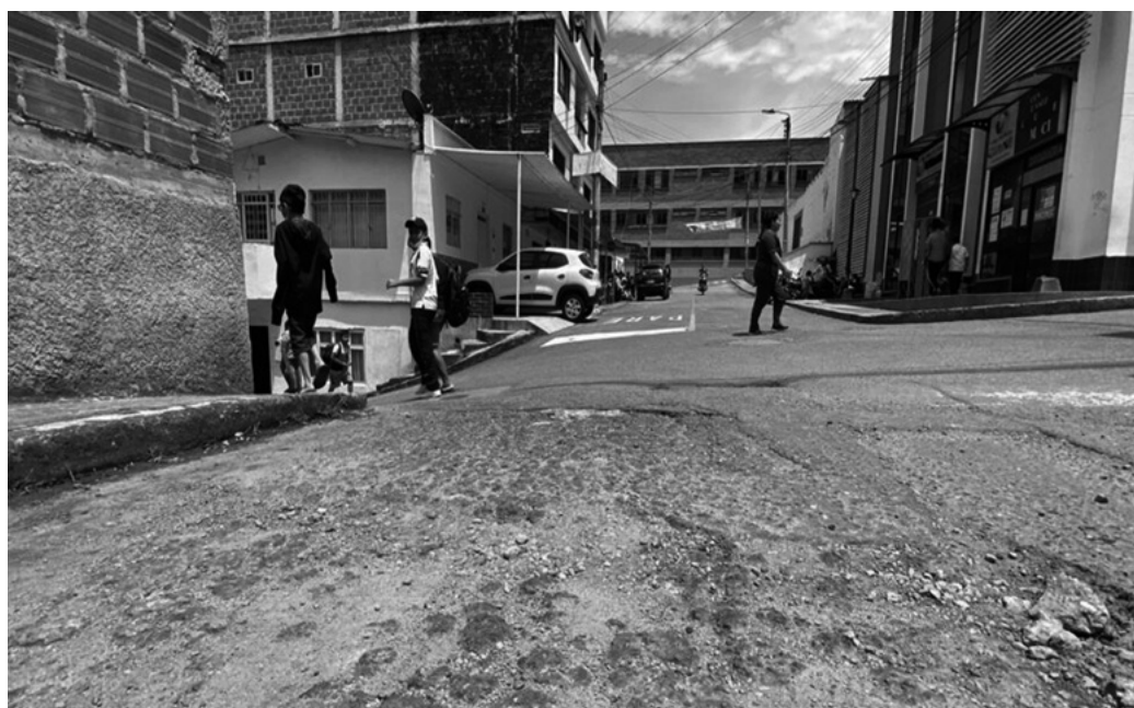
FIGURA 10 | El espacio público en el sector de La Cumbre en Floridablanca, Santander, carece de arborización y las calles se encuentran en un estado deficiente, lo que genera inseguridad para los peatones que transitan por la zona. Fuente: Q'Hubo, 2022.
