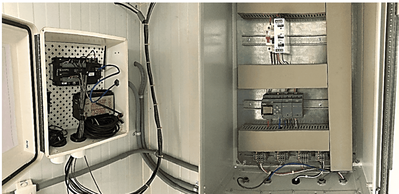
Figura 4 Datalogger CR6 y gabinete eléctrico del LOGO
