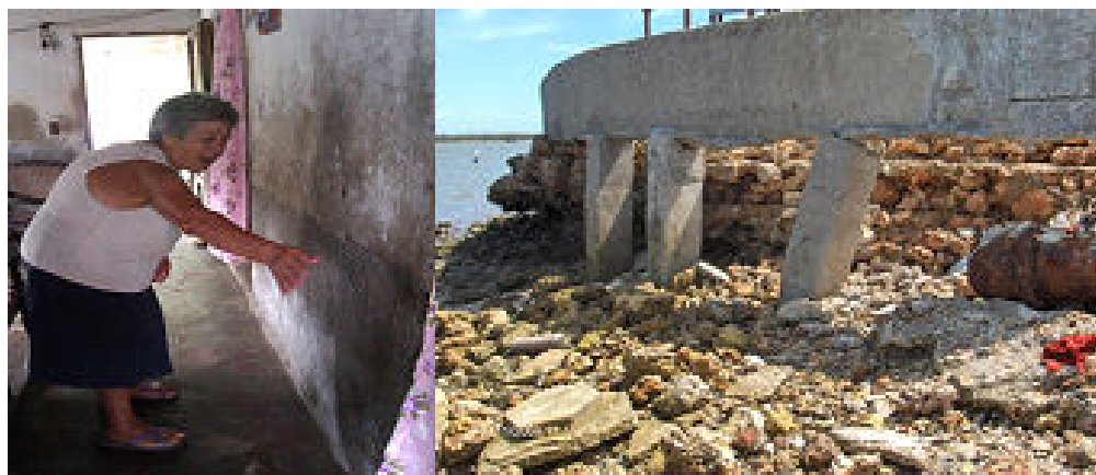
Figura 6. Marca de agua en una vivienda (izquierda) y afectaciones la Cafetería El Flamenco (derecha).
