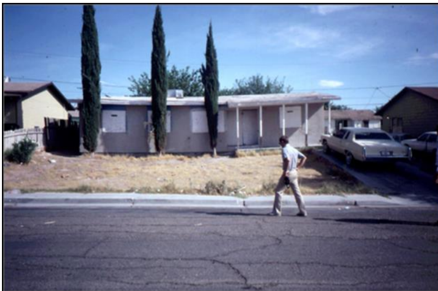
FIGURA 3 Fotografía de una casa con daños estructurales producto del proceso de subsidencia en Windsor Park al norte de Las Vegas Fuente: Bell, 1992.
