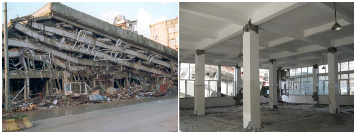
Figura 1. Daños en terremotos recientes. Izq. Falla de piso por viga fuerte columna débil. Der. Plastificación de extremos de columnas.
