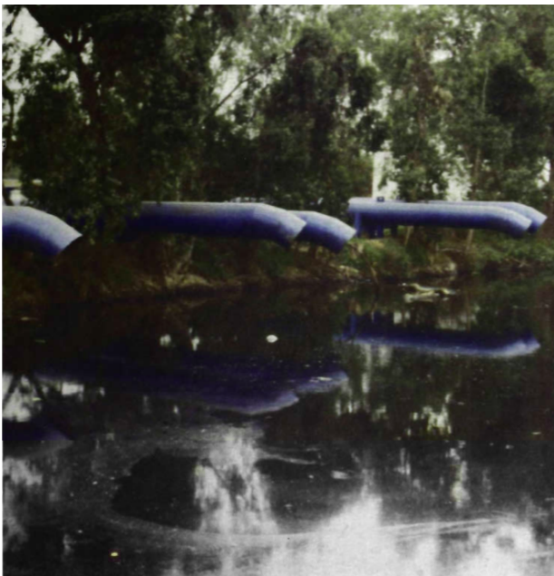
Imagen 2 Canal Nacional, 2006; con tubos de descarga de drenaje provenientes de la zona Coapa.
