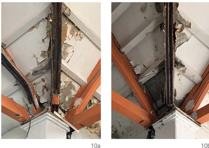
Figura 10a. Deformaciones estructurales en las armaduras portantes de la cubierta de la casa de bombas. (10b) por los daños se observa el uso del hierro revestido de concreto en armaduras y viguetas. Nativitas, febrero de 2022.
