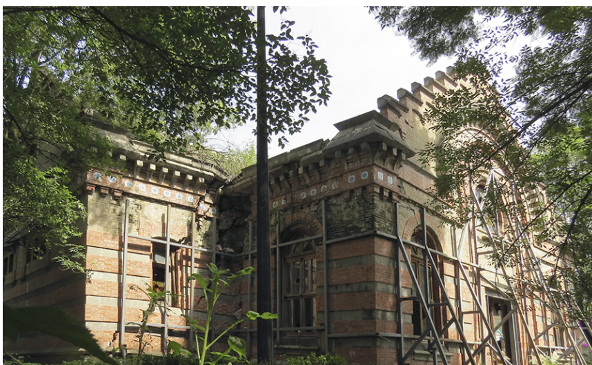
Figura 8. Desde la fachada principal se muestra el estado ruinoso y las intervenciones inconclusas. Fachada principal de la casa de bombas Nativitas . Nativitas, febrero de 2020.
