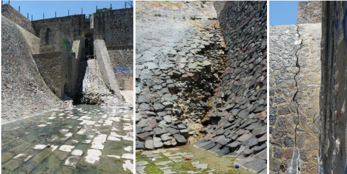
Figura 7. Tres vistas de la cortina de mampostería en 2012, de izquierda a derecha: vista al desagüe de fondo y al desfogue de la obra de toma; detalle de pérdida del material constitutivo de la cortina y detalle de grieta vertical. Fotografías del autor
