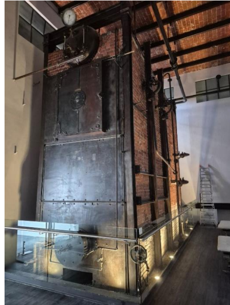
Figura 11. Caldera de vapor Babcock and Wilcox, La constancia mexicana (restaurada). Fuente: cortesía de la Mtra. Elizabeth Popocatl, 2025
