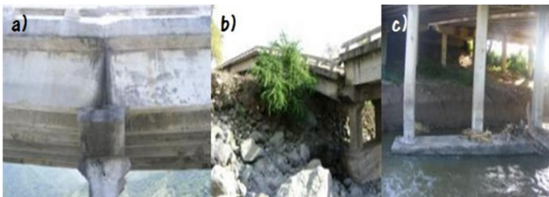
Figura 2. Puentes prefabricados de hormigón, fallos por socavación, carreteras de Santiago de Cuba.
