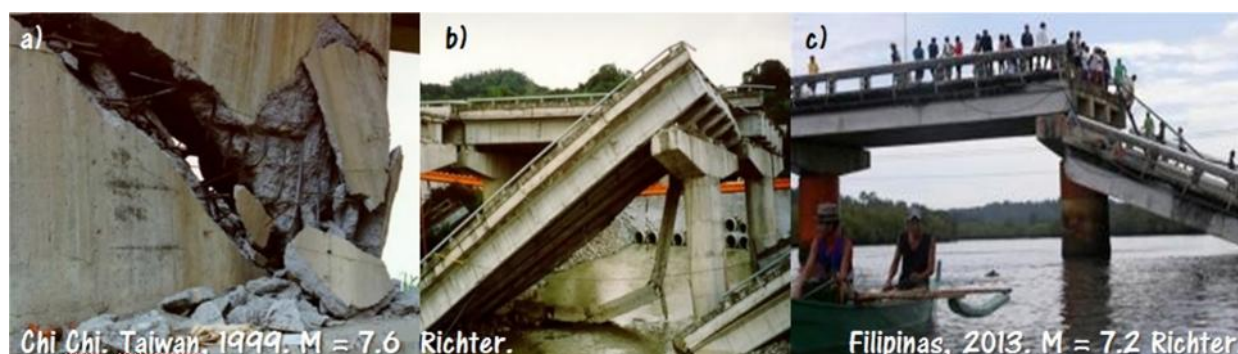
Figura 1. Puentes dañados durante terremotos fuertes. a) Grieta diagonal por cortante en pila de hormigón poco reforzada, puente Wu shu, Taichung. b) Colapso de tramos, puente Shi wei, Taichung (Buckle, Friedland, Mander, Martin, Nutt and Power; 2006). c) Caída de tramos.
