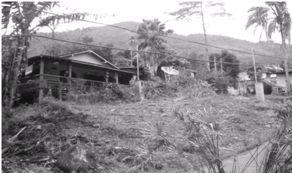
Ocupação na encosta: edificação de residências acima da cota de 40m (permitida por Decreto Municipal); retirada da vegetação original em área protegida e preparo do terreno para mais uma edificação.
