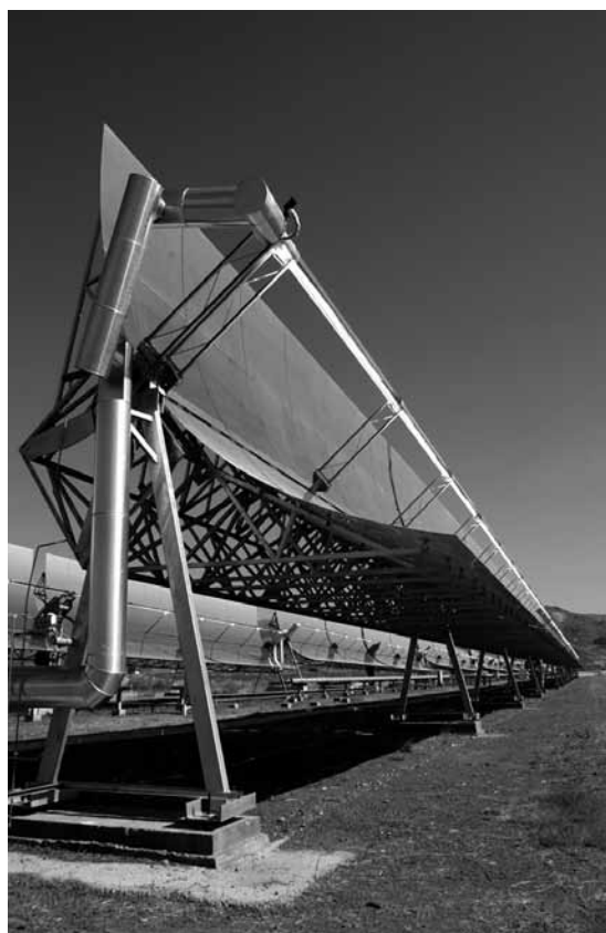
Figura 1. Vista de captador solar cilindroparábólico en seguimiento solar de la instalación DISS para la generación directa de vapor (Plataforma Solar de Almería, España).
