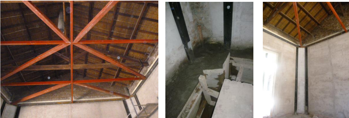
Figura 12. Emparrillado metálico triangulado a nivel de techo, anclaje de columnas en vigas de fundación y columnas y vigas metálicas de encadenado ancladas en la mampostería
