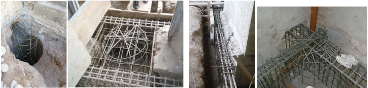
Figura 11. Excavación de pozo, detalle de armado de cabezal, de vigas exteriores al cimiento existente y encuentro de vigas interiores y cabezal de fundación
