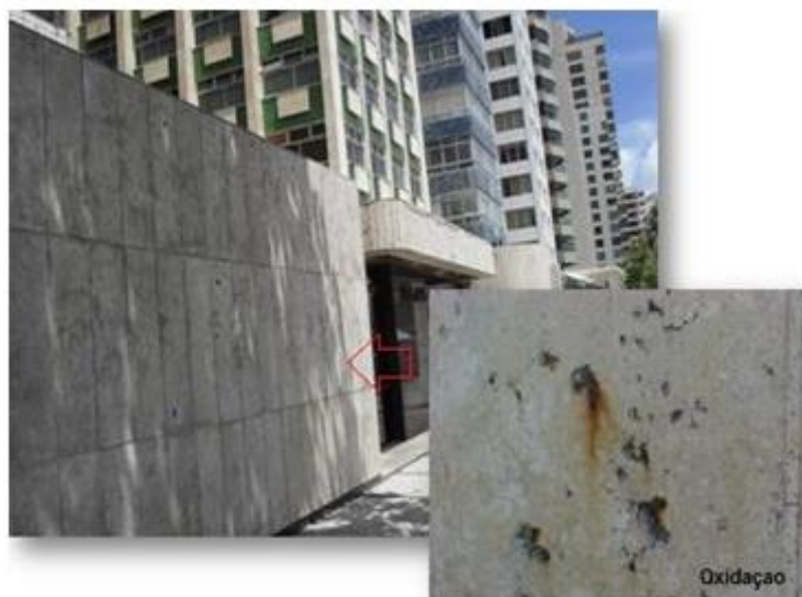
Figura 2 - Aspecto de fachada com revestimento de Bege Bahia, com 20 anos de exposição. Notar a segregação secundária (detalhe) resultante da mobilização e reprecipitação de Fe sob influência intempérica.
