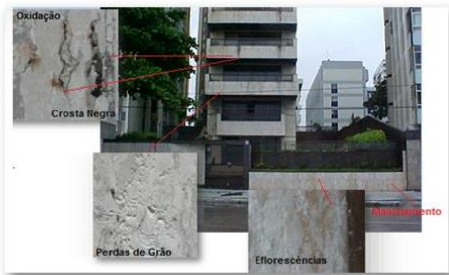
Figura 1 – Ocorrências de patologias em edificação localizada na região litorânea do Recife.
