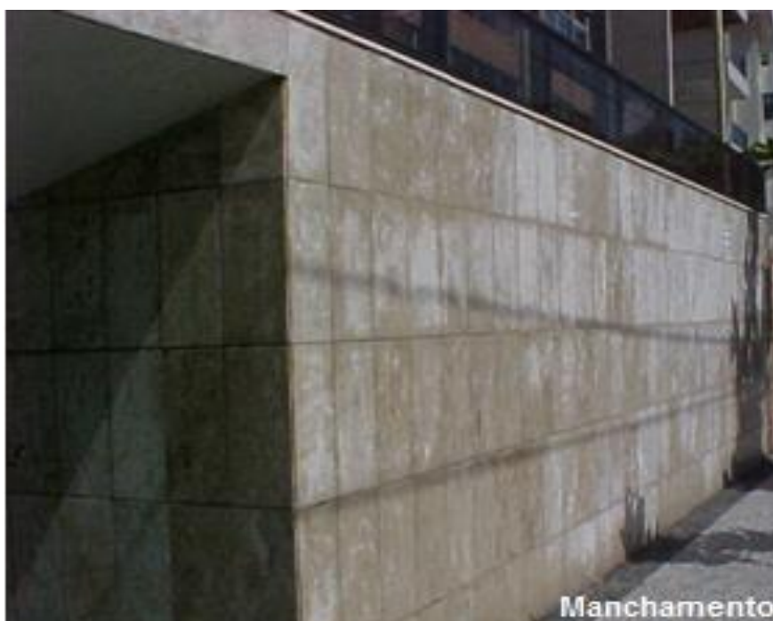
Figura 3 – Manchas observadas em fachada externa de prédio situado na região litorânea do Recife.
