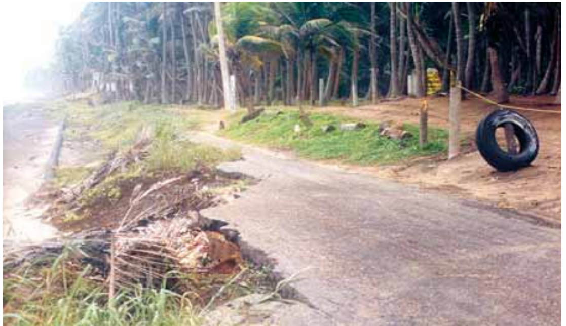
Figura 6. Ruptura de la carretera costera como resultado del retroceso de la costa, en el poblado El Alacrán (hoja E15A78, Cocohital), en el estado de Tabasco (septiembre de 2004).
